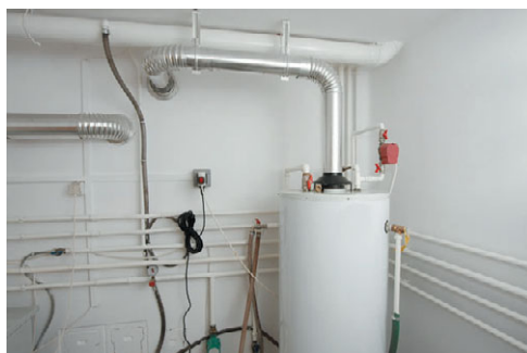
Рис. 12.1. Современная система отопления
