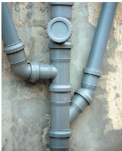
Рис. 8.1. Канализационные трубы в современном доме
