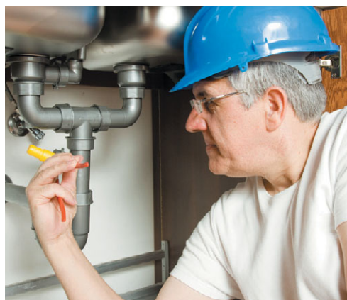
Рис. 11.1. Сантехнические приборы время от времени требуют ремонта
