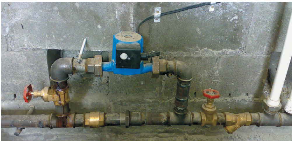
Рис. 2.9. Байпас, установленный в системе отопления
