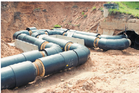
Рис. 5.5. Трубы с утеплительным слоем из минеральной ваты
