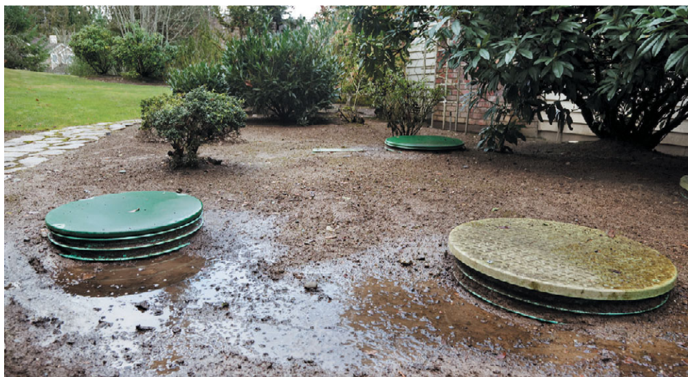
Рис. 8.23. Благоустроенная автономная канализационная система в загородном доме
